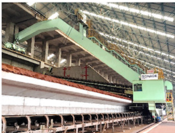
SCHADE Halbportalkratzer für Baosteel im Betrieb (Foto SCHADE)
