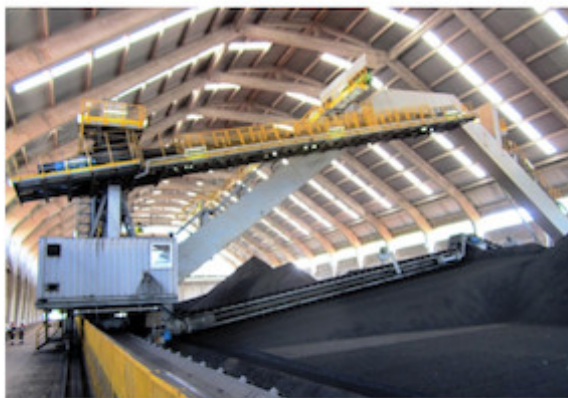
Beispiel für einen typischen SCHADE-Halbportalkratzer im Einsatz bei Cerro Blanco in Ecuador (Foto SCHADE)
