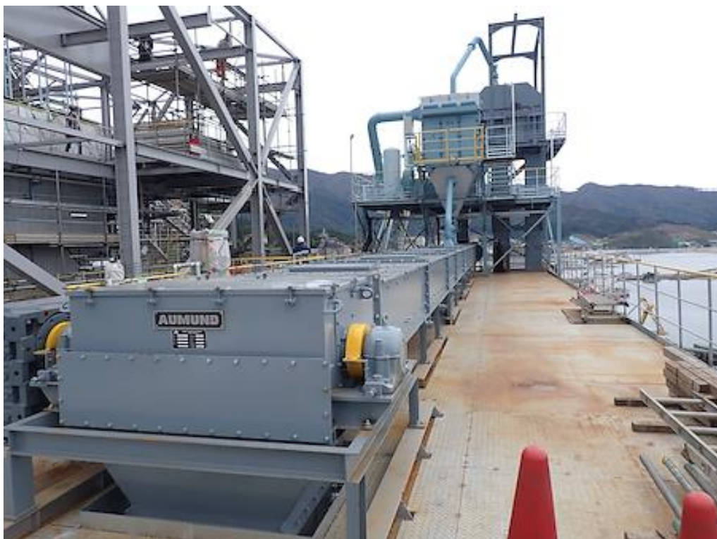
AUMUND-Trogkettenförderer Typ LOUISE TKF für das Handling von alternativen Brennstoffen im Kraftwerk Ofunato von Taiheiyo Cement in der Präfektur Iwate/Japan (© AUMUND)
