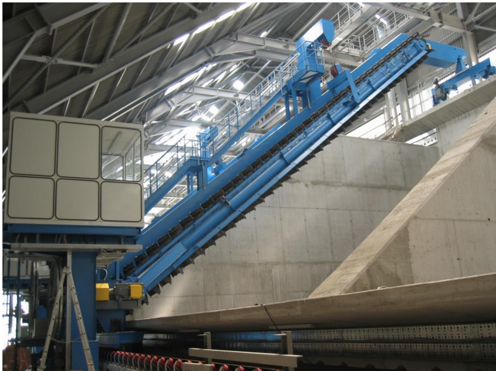
Die seit 2001 betriebene SCHADE-Referenzanlage bei Saloni Anovo, Slowenien, trug zur Auftragsvergabe von RUSAL bei (Foto SCHADE).
